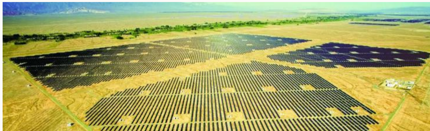
甘肅酒泉100MW地面太陽能电站
