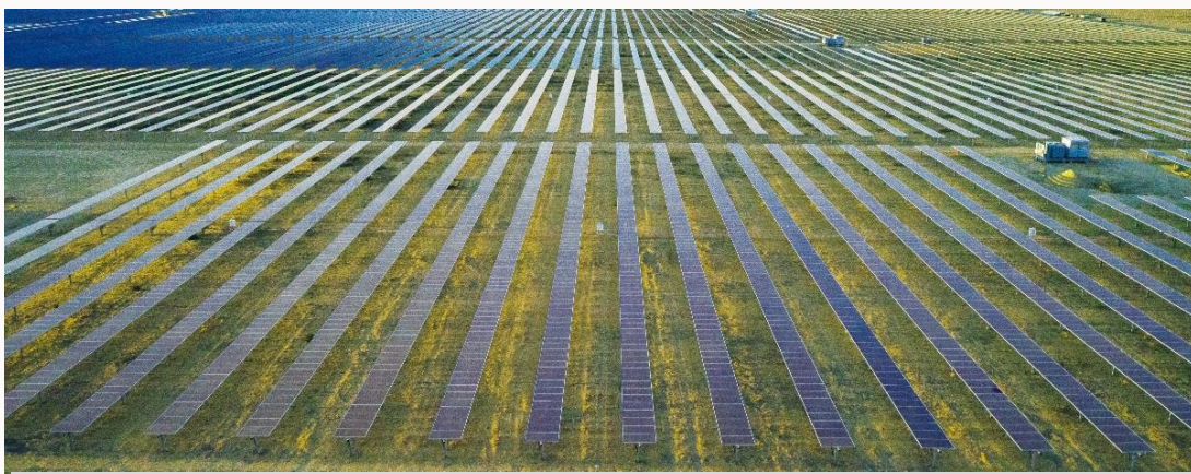
美国205MW光伏电站
