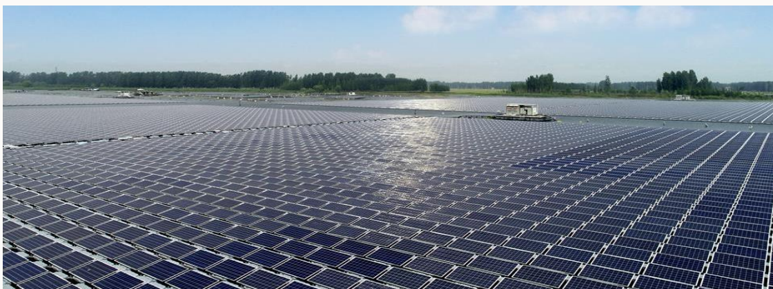
濟寧微山100MW漂浮式太陽能电站項目
