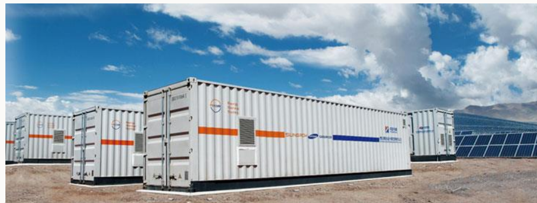
西藏雙湖7MW23.5MWh光儲微電網項目
