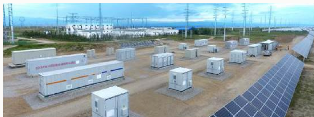
青海10MW5.5MWh調頻輔助新能源並網項目
