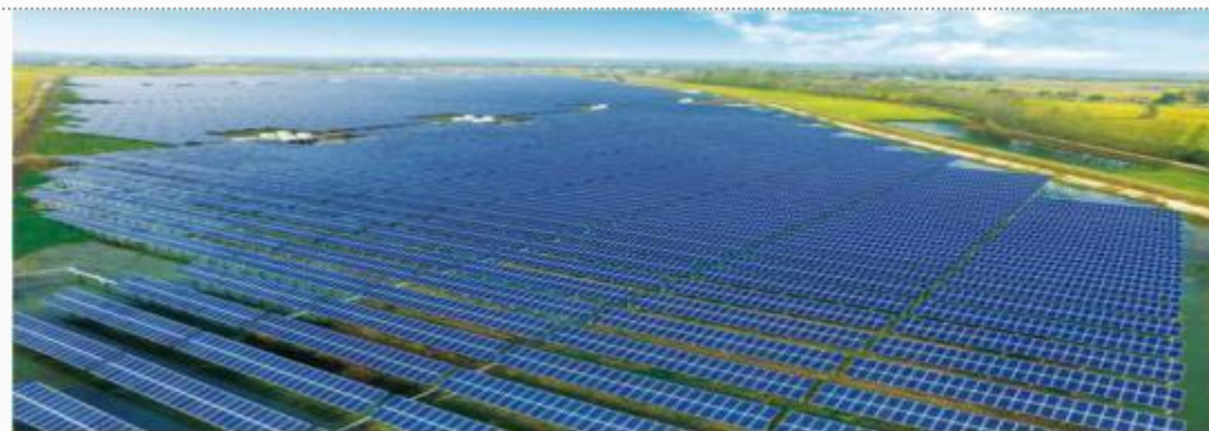
合肥肥東石塘鎮40MW漁光互補太陽能电站項目
