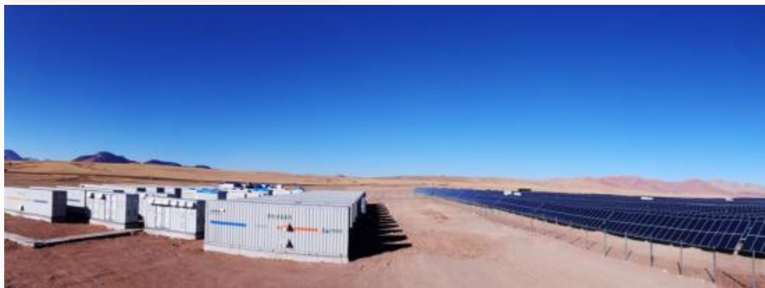
西藏尼瑪太陽能9MW、儲能9MW30MWh光儲微電網項目
