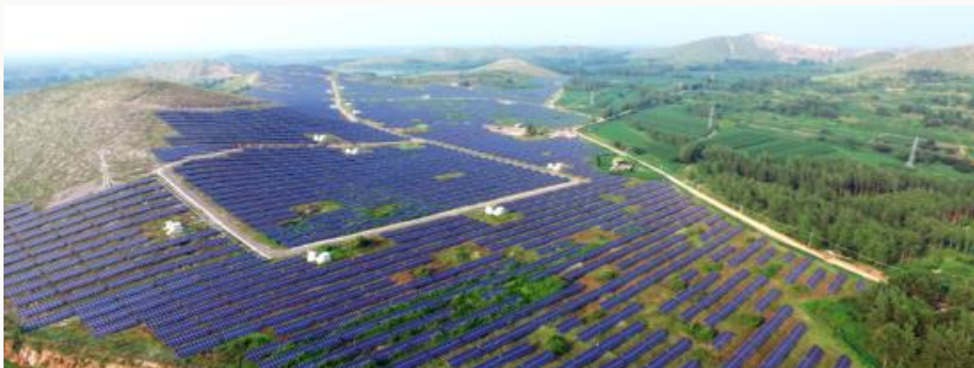
靈璧120MW地面集中式太陽能電站
