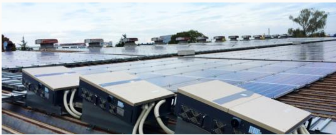
日本100kW商業屋頂太陽能电站
